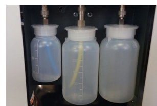
A1 zbiornik na olej zużyty, 1 zbiornik na olej nowy i 1 zbiornik na UV
